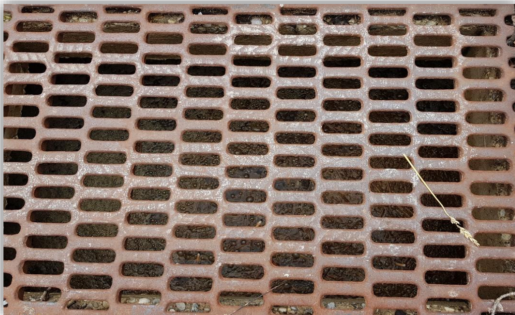
Abb. 56: Foto der Abdeckung des Güllelochs bei einem am Projekt beteiligten Landwirt
